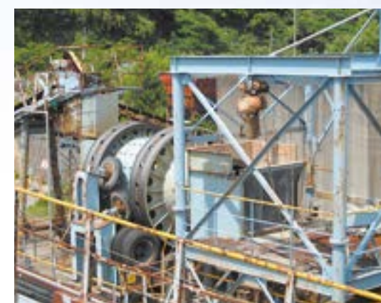
ボールミル 砂利を破碎して付加価値の高い砂を生産し、安定供給を実現しています。
