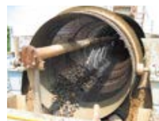
トロンメル・第一次選別 投入された原石は、トロンメルにより粗骨材と細骨材に分けられます。
